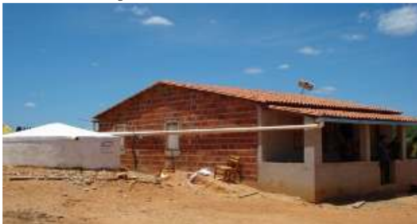
Figura 01 – Cisterna de placas para armazenamento de água voltada ao consumo humano
