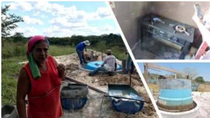
Figura 2 – Biodigestor sertanejo construído no Assentamento Dom Tomás, Território Rio Vermelho, município de Goiás Velho – GO.
