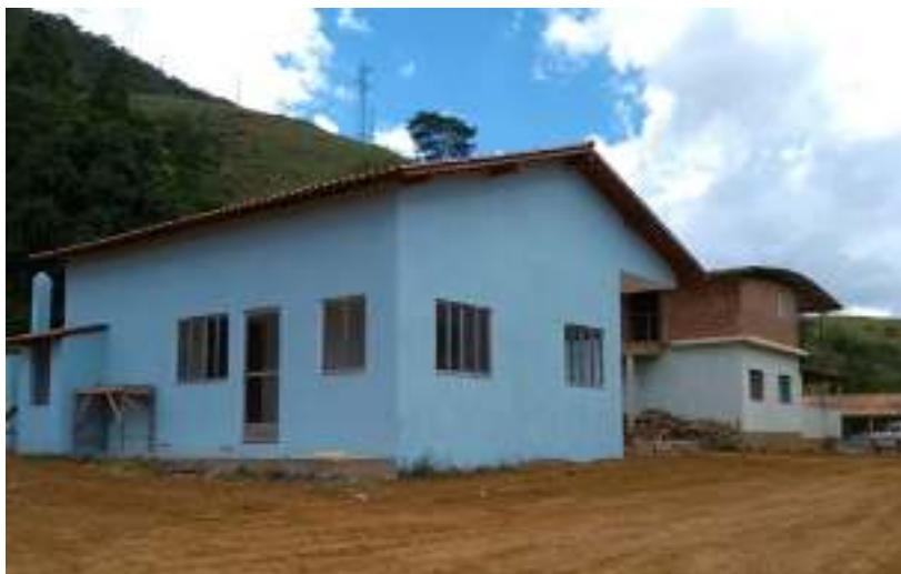
Foto 3 - Construção da Agroindústria de polpa de frutas Das Camponesas no Assentamento Florestan Fernandes em Guaçuí, ES em 24/10/2018 (fotografia de Renata Moreira)
