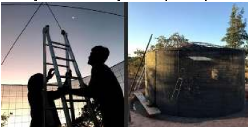
Figura 5 – Sistema de Captação de Água da Chuva. Assentamento Padre Ilgo, Território Médio Araguaia, município de Caiapônia - GO.
