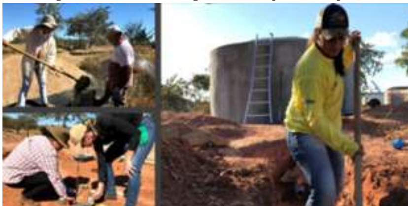
Figura 4 – Sistema de Captação de Água da Chuva. Assentamento Padre Ilgo, Território Médio Araguaia, município de Caiapônia - GO.
