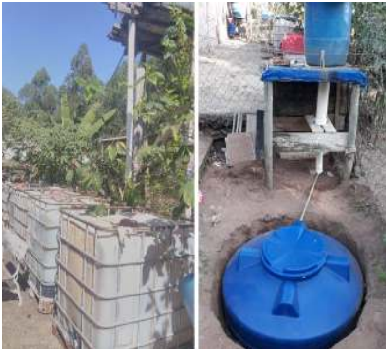
Figura 19 - Tanques brancos; sistema de filtração e armazenamento da água filtrada
