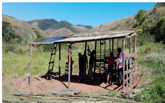
Figura 10. Foto da estrutura do galpão construído depois de instalado o sistema. Fonte: próprio autor
